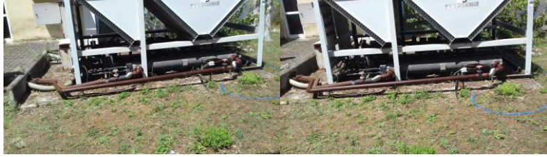
Εικόνες εξωτερικών σωλήνων προς μόνωση
