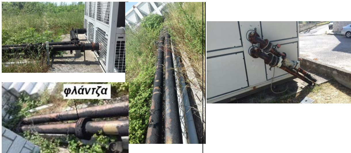
Υφιστάμενη κατάσταση μόνωσης σωληνώσεων κλιματισμού κτηρίου ΑΑΤ στο campus Κωστακίων
