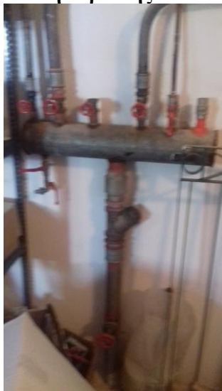
Κεντρική είσοδος νερού κτηρίου Διοίκησης στην Άρτα
